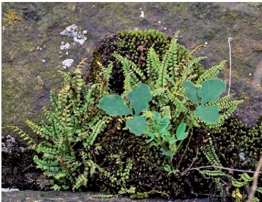
Fot. 5. Kępki zanokcicy zielonej Asplenium viride na wiadukcie kolejowym w Janowicach Wielkich, 21.06.2013 (fot. G. Wójcik).
