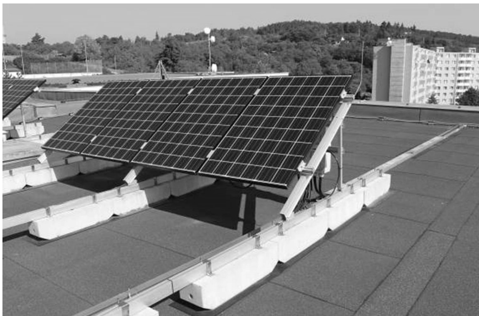
Obr. 3: Fotovoltaická elektrárna Kamínky (© Doskočilová).
