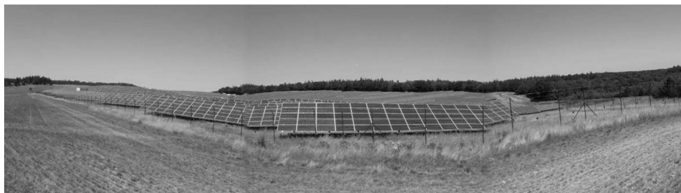
Obr. 2: Fotovoltaická elektrárna Vranovská Ves (© Doskočilová).
